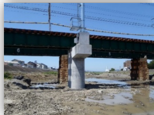
例) 橋脚に計測器を設置
