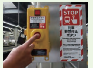
駅ホームの非常停止ボタン
