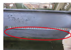
台車の亀裂発生場所
