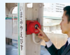
駅ホームの非常通報ボタン
