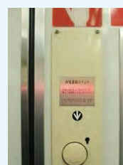
車内非常通報装置
