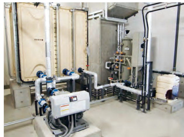
泉大津駅の中水受水槽
