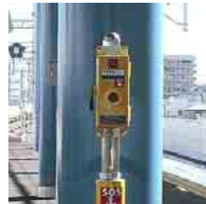
非常通報ボタン
