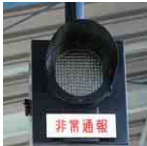
非常通報表示灯
