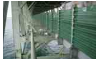
空港連絡橋防風柵 関西国際空港(株)提供
