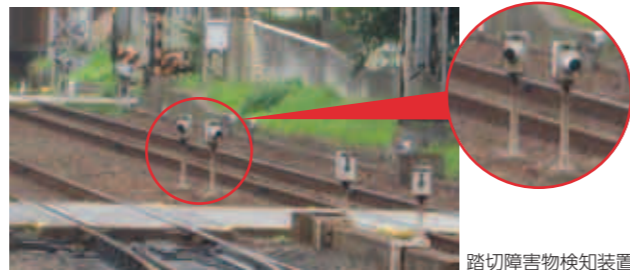
踏切障害物検知装置
