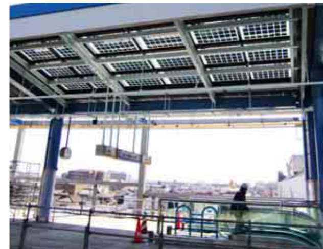
泉大津駅ホーム上屋の太陽光パネル
