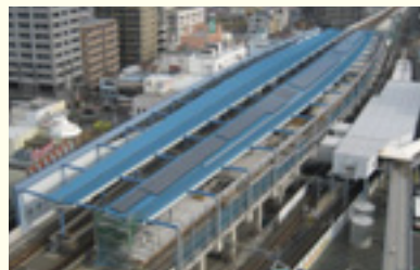
泉大津駅の太陽光発電システム
