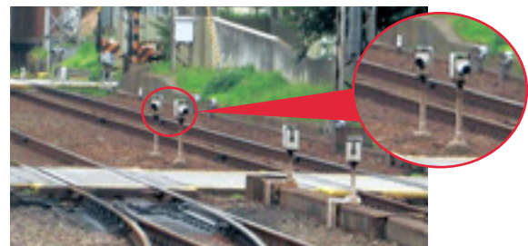
踏切障害物検知装置
