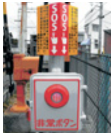
踏切支障報知装置
