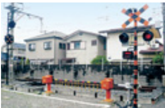
研修用踏切保安設備
