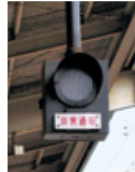
非常通報表示灯
