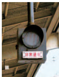
非常通報表示灯
