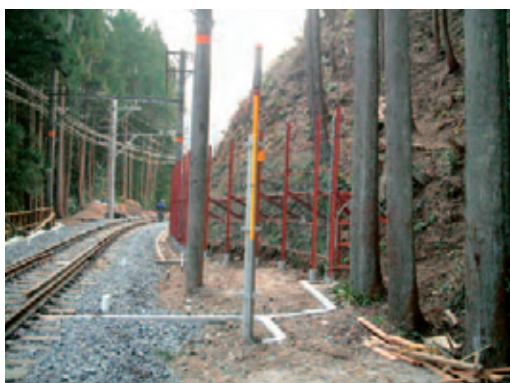
落石警報装置
