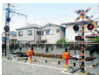
研修用踏切保安設備
