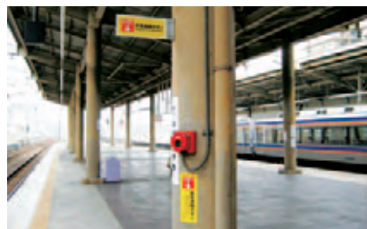
非常通報ボタン
