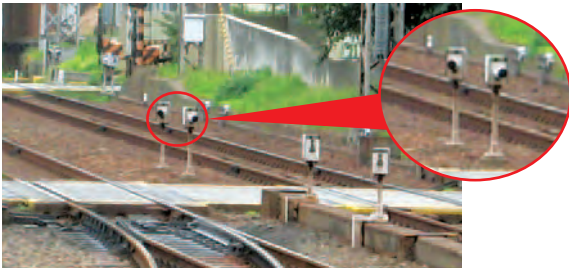
踏切障害物検知装置
