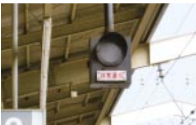
非常通報表示灯
