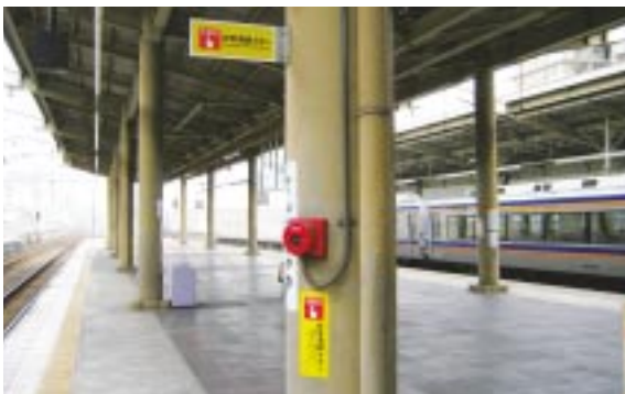
非常通報ボタン
