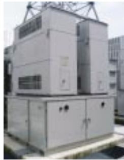
純水沸騰冷却式シリコン整流器
