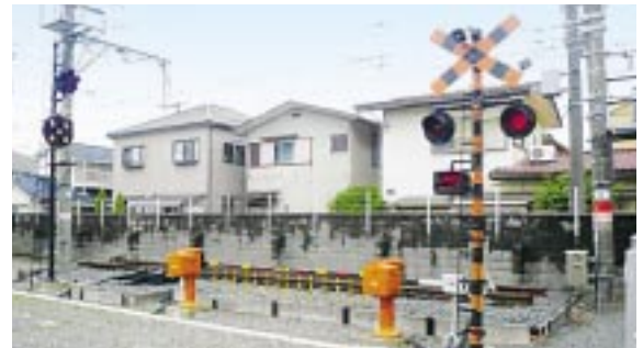
研修用踏切保安設備
