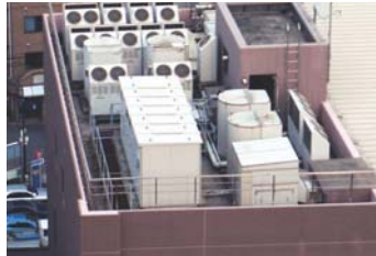
氷蓄熱空調システム室外機（南海日本橋ビル）
