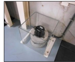
地震警報装置・7 か所
