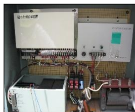
冠水警報装置・3 か所
