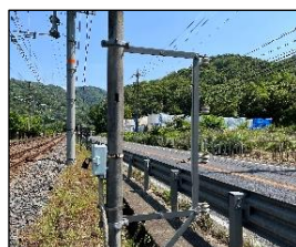
自動車転落警報装置・2 か所
