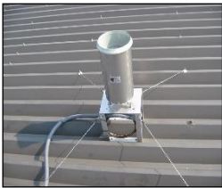
雨量警報装置 15 か所
