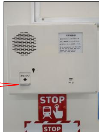
車内非常通報装置
