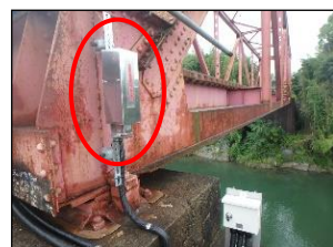
橋梁異状検知装置・4 か所
