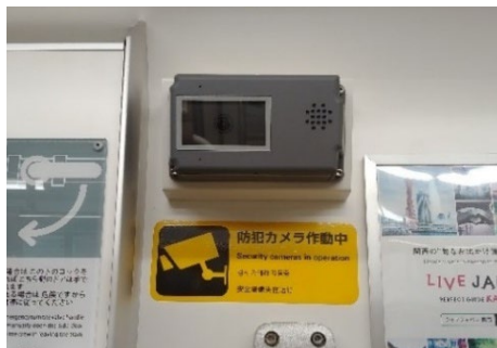
車内に設置している防犯カメラ
