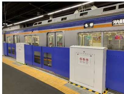
なんば駅に設置済みの大開口ホーム柵
