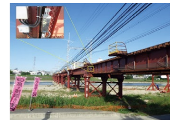
橋梁異状検知システム(高野線大和川橋梁)
