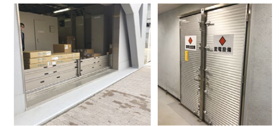
防潮堤(左)と止水扉(右)(玉出総合事務所)
